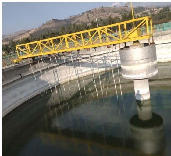
Figura 3. Tanque decantador secundario Digestor De Lodos. Fuente: Trabajo de campo (2023)
