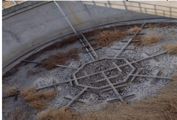
Figura 4. Tanque digester de lodos. Fuente: Trabajo de campo (2023)
